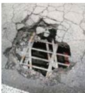
床版の疲労による 部分抜け落ち
