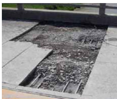
凍害による 床版上面の損傷
