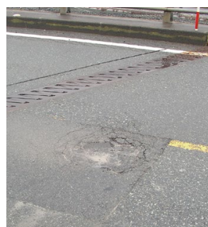
鉄筋のかぶり不足等による ポットホール
